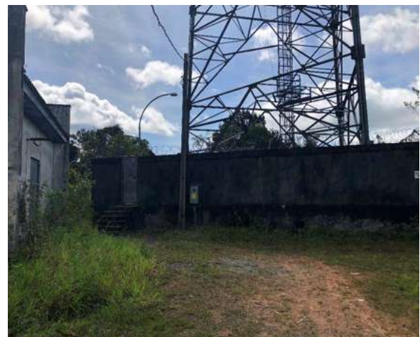
Torres de telefonia sem sinalização de alerta de perigo Fonte: visita técnica 03/06/2022
